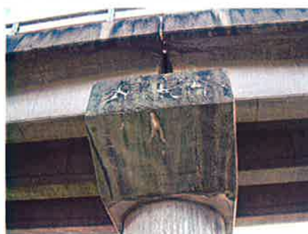
図 1.4 コンクリート橋の損傷状況
