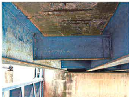
図 1.3 鋼橋の損傷状況
